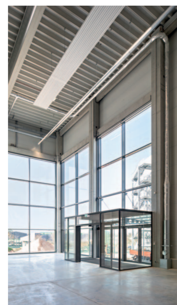
Um die Anforderungen an den Schallschutz zu erfüllen, musste nachträglich ein Windfang integriert werden
