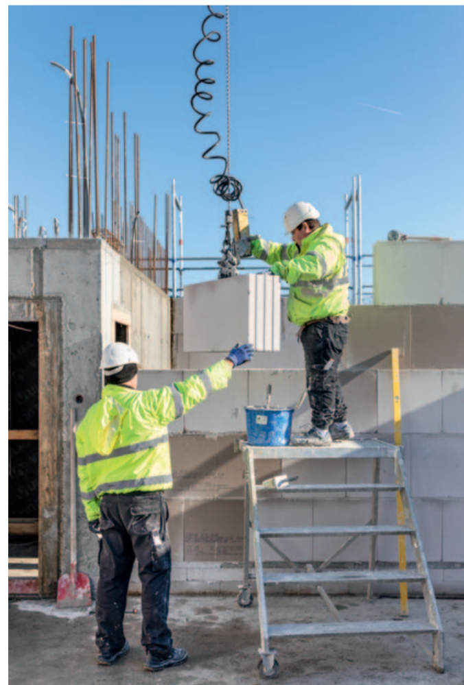
Beim Mauern der wärmespeichernden Kalksandsteine für die Außenwand ist handwerkliches Geschick gefragt
