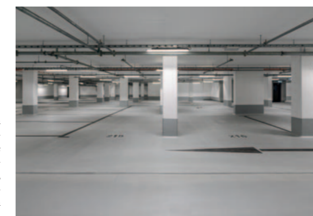
Unter den Gebäuden erstreckt sich eine zweigeschossige Tiefgarage mit 278 PKW-Stellplätzen sowie Fahrrad-, Abstell- und Technikräumen
