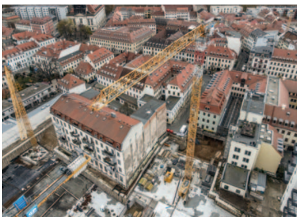
Der Beginn der Rohbauarbeiten verschob sich – nicht nur zeitlich, sondern auch geografisch: Aufgrund der verzögerten Erstellung der Baugrube mussten wir an anderer Stelle starten
